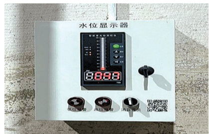
11月16日，贵州省毕节市，鹰派教育学校消防水位显示器显示缺水。
