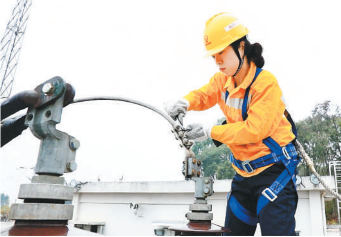
李怡琴在检查变电设施设备。
