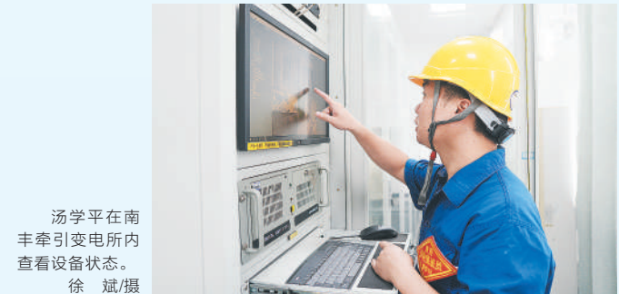
汤学平在南丰牵引变电所内查看设备状态。
