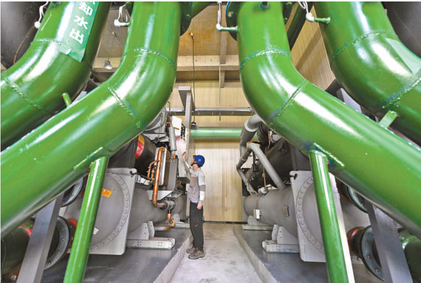
2024年8月5日，杭州医药港小镇1号能源站，冷水通过管道输送到园区建筑物内，降低企业生产空间环境温度，实现“集中供冷”。
