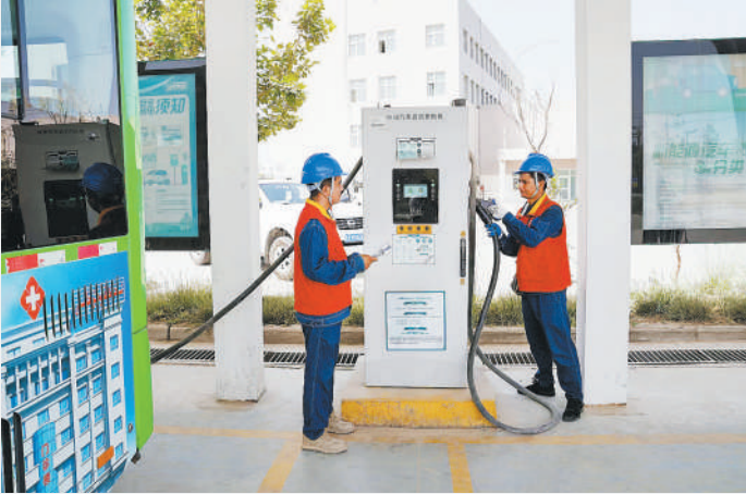
6月24日，国网和田供电公司共产党员服务队来到新疆和田都玉客运有限责任公司洛浦站，对电动公交车充电桩进行安全用电检查，保障充电设备安全运行，并为车站工作人员宣传安全用电知识，助力城乡居民绿色出行。
