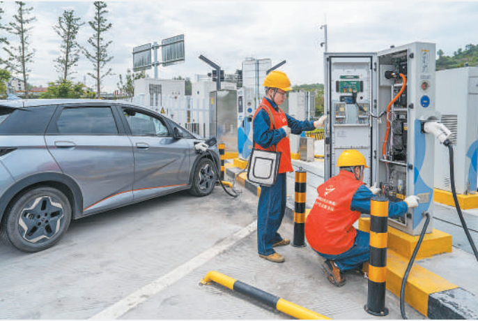
随着暑期旅游旺季的到来，新能源汽车自驾出行需求或将大幅增加，对充电基础设施及电网服务水平提出了更高要求。在浙江省南昌高速服务区，国网绍兴供电公司青年志愿者队对充电桩设施进行维护保养，确保来往新能源汽车主能够安全充电。
