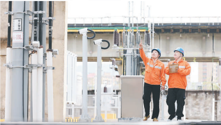
陈瑶（左）和同事在巡视变电所变压器设备。
