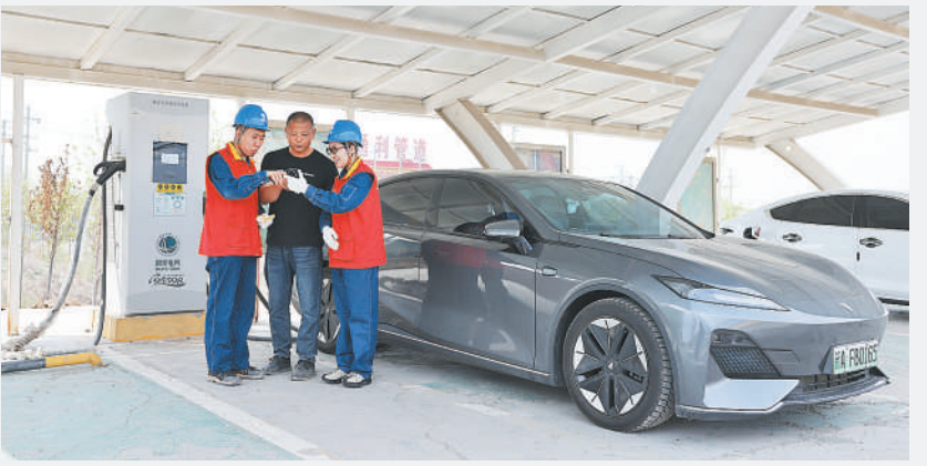
今年“五一”假期,新疆的独特美景吸引了众多游客自驾出行。为了保障新能源车车主在假期的充电需求,国网新疆昌吉供电公司“易车行联盟”对区域内充电站充电趋势做了预测分析,同时组织员工对19座充电站、37个充电桩进行巡检检查,确保每个充电桩都能充电,满足群众的绿色出行需求。 张桂花摄
